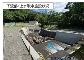
下流部: 上水取水施設状況
