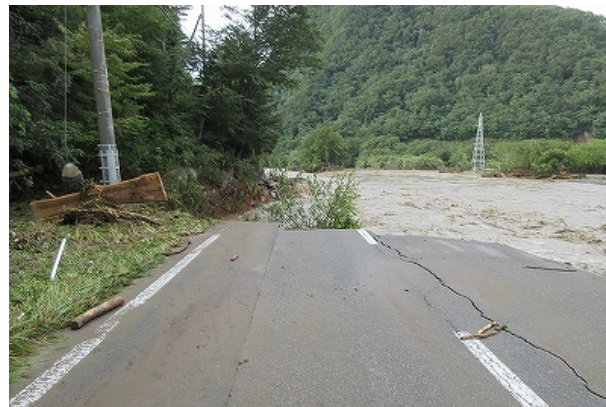
道路流出状況 （国道 455 号：乙茂地区）
