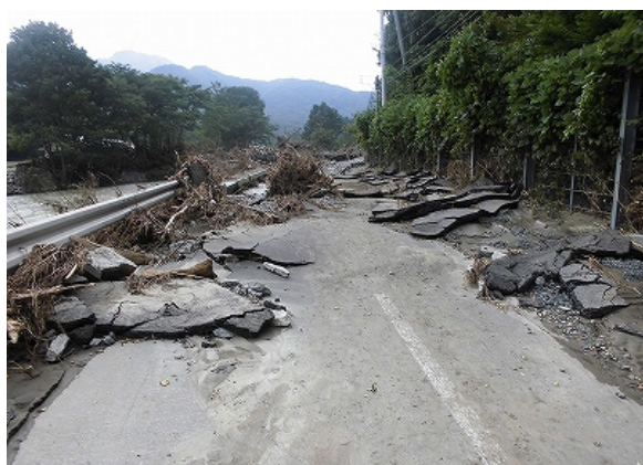
道路被災状況 （県道普代小屋瀬線：氷渡地区）
