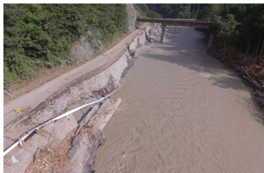
国道 455 号被災状況（H28. 9）
