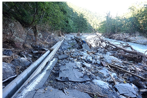
道路流出状況 （県道普代小屋瀬線：年々地区）
