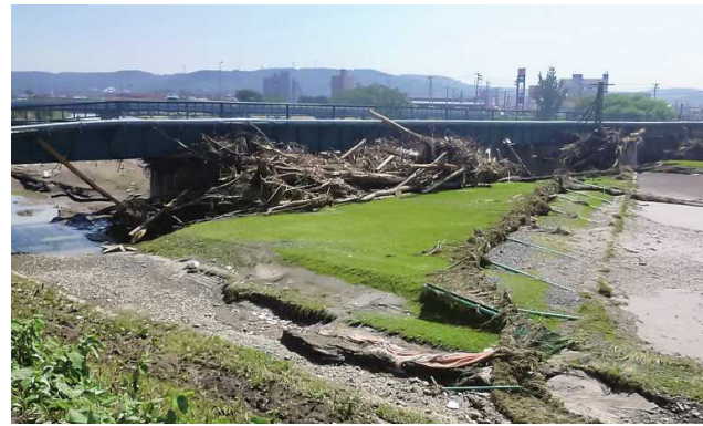
久慈市久慈川流域の被害状況
