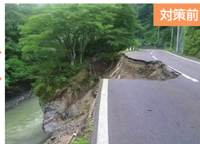
久慈市案内〜戸呂町口地区の被害状況
