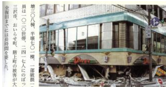
図6-45 三陸はるか沖地震で1階がつぶれた八戸市のパチンコ店
