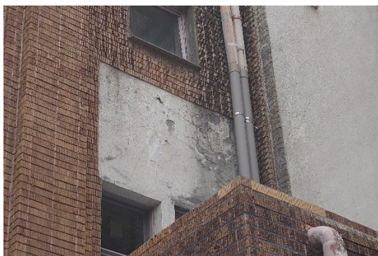
図 33：外壁部分のひび割れ
