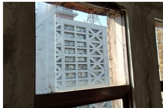
図 46：塔屋窓の破損状況
