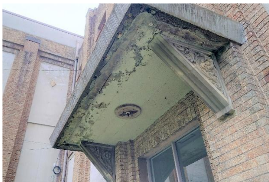
図 35：旧傍聴人玄関庇の破損状況
