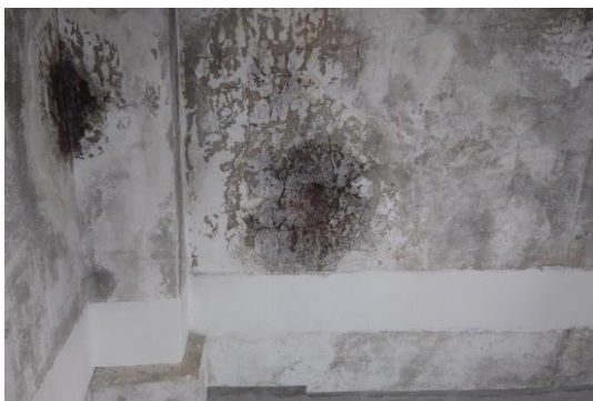
図 45：塔屋の水漏れ箇所
