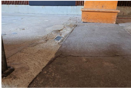
図 40：大ホール床面の段差
