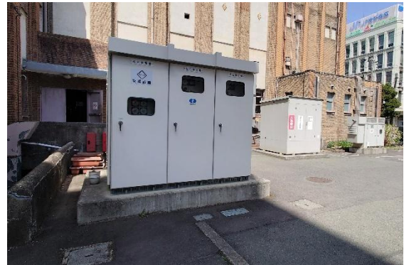
図 60：屋外受変電設備
