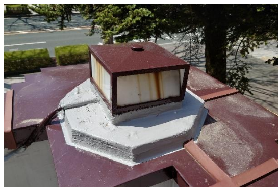
図 36：正面入口の庇の電灯の破損状況
