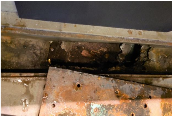
図 39：舞台正面の排水溝の破損状況
