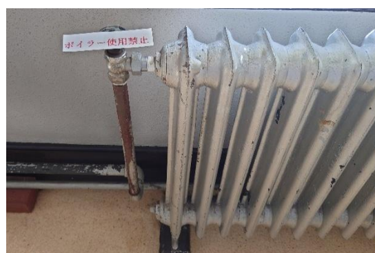
図 38：暖房の破損状況
