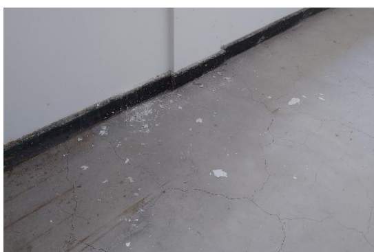
図 37：漆喰の散乱状況
