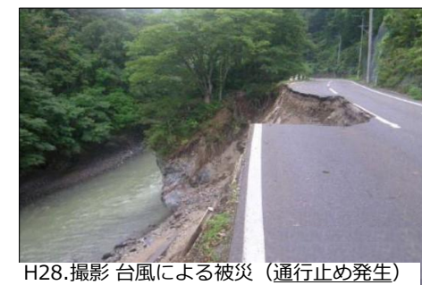
H28.撮影 台風による被災（通行止め発生）
