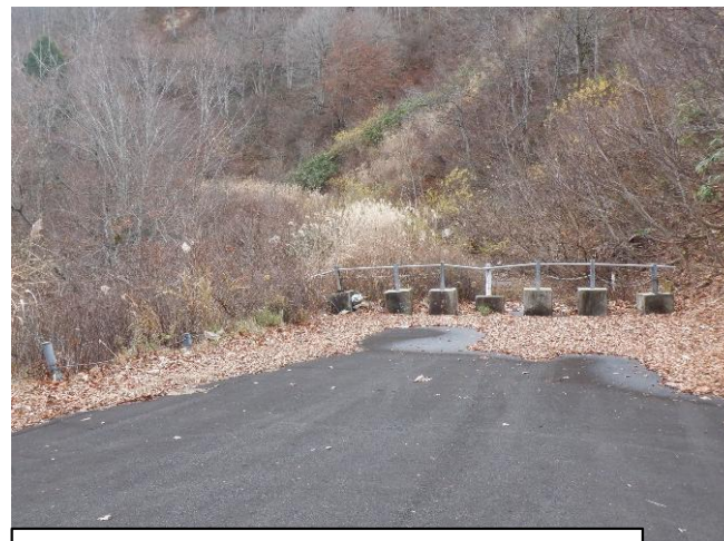
R5.11月撮影(岩手県側通行止め箇所)
