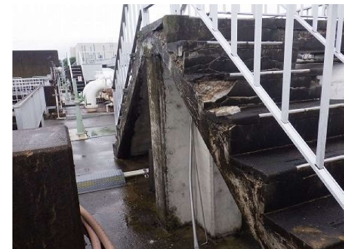
写真：破損した階段 (都南浄化センター反応タンク)
