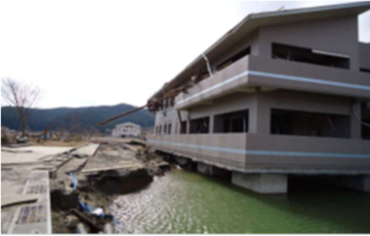
Rikuzentakata Septic Center
