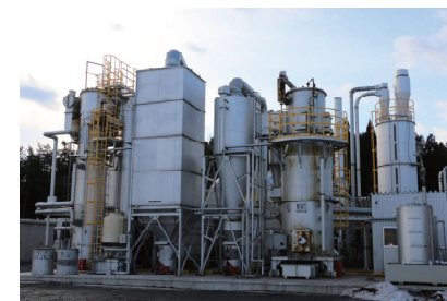
バイオマスボイラー
