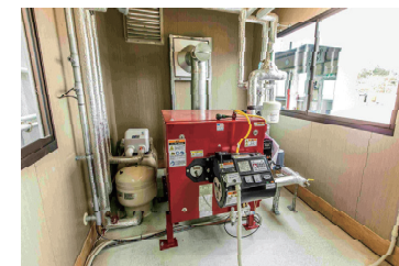
廃油ボイラー
