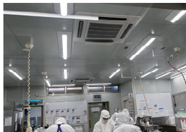
工場のLED照明
