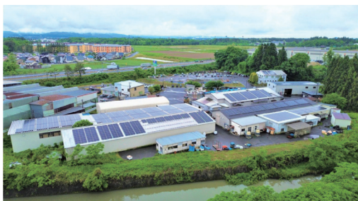
屋根上の太陽光発電設備
