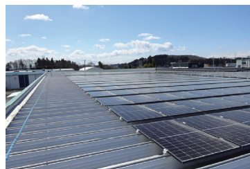
第2工場の屋根上に設置した太陽光パネル
