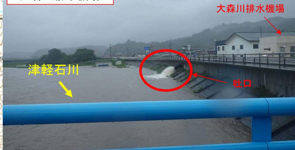
大森川排水機場（吐口付近）
