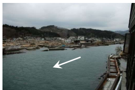
関口川 下流部破堤状況
