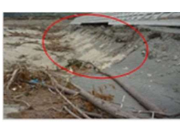
防潮堤裏法の洗堀状況
