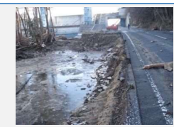
水門より上流側（右岸）の被災状況
