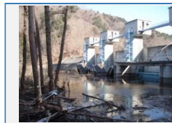
普代水門の被災状況
