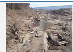
水門より下流側（左岸）の被災状況
