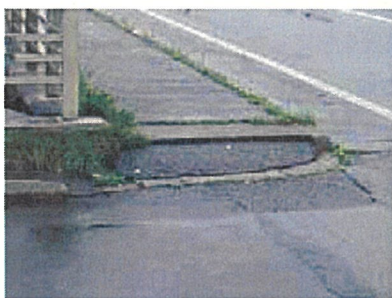
すり付けが必要な路面
