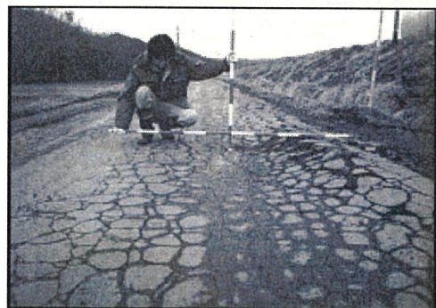
舗装面の盛り上がり、沈下
