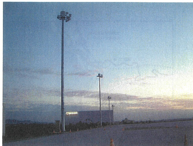
新設エプロン照明灯柱
