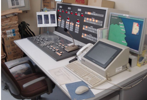
久慈消防署種市分署の津波・高潮防災ステーション操作局
