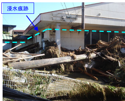
松川氾濫による下田保育園浸水痕跡 (盛岡市玉山区下田地区)
