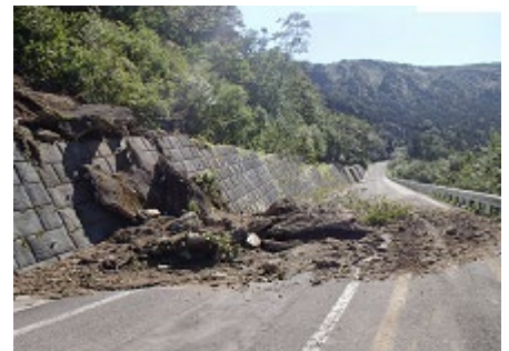
県道八幡平公園線法面崩落 (八幡平市北の又山地区)
