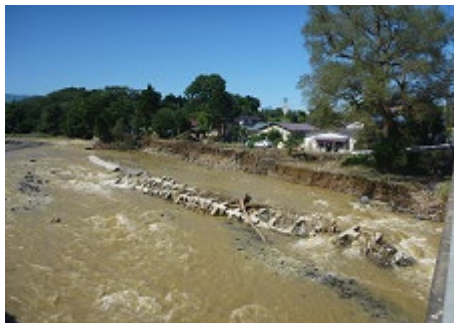
松川上流左岸の護岸決壊 (八幡平市大更地区)
