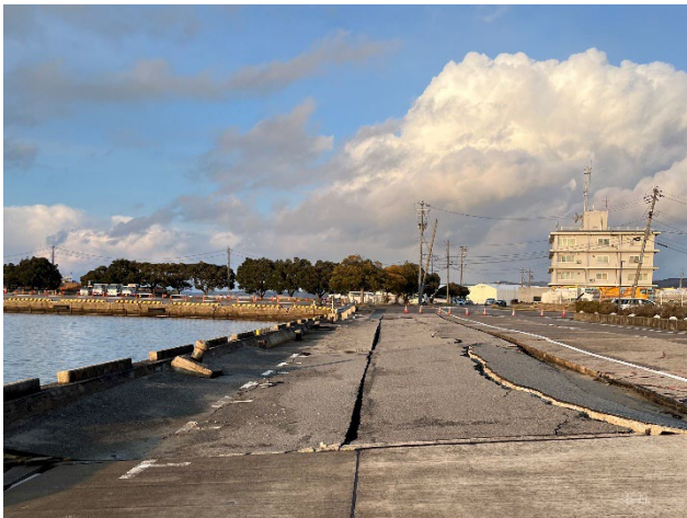
▲地震により沈下した港湾施設（七尾港）
