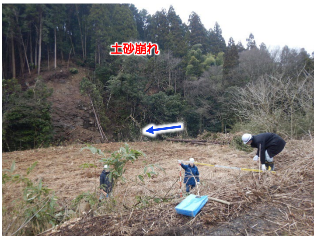
▲災害査定に向けた被災現場調査、測量の様子（河内川）
