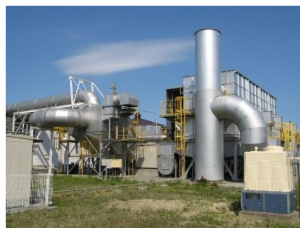
RTO 設置 (蓄熱燃焼式排ガス浄化装置)
