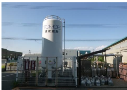
液体窒素 (LN2) タンク
