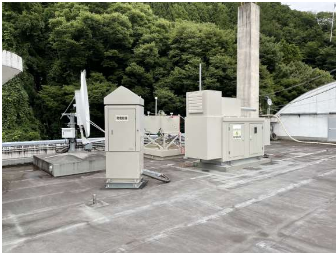
設置した自家発電機（庁舎屋上）
