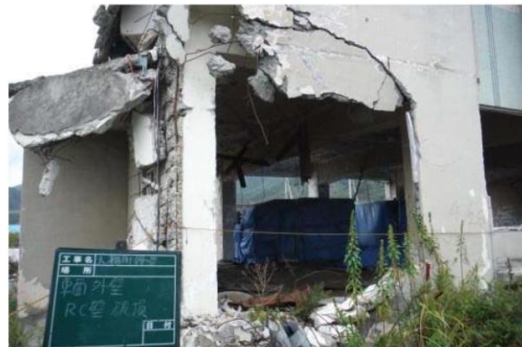
外壁・庇破損
