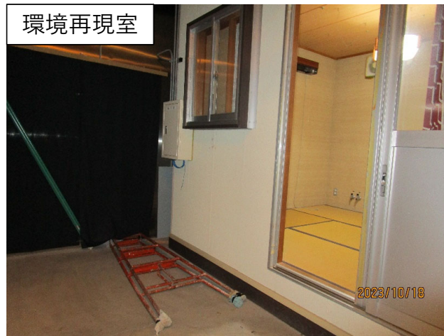
庁内の老朽箇所
