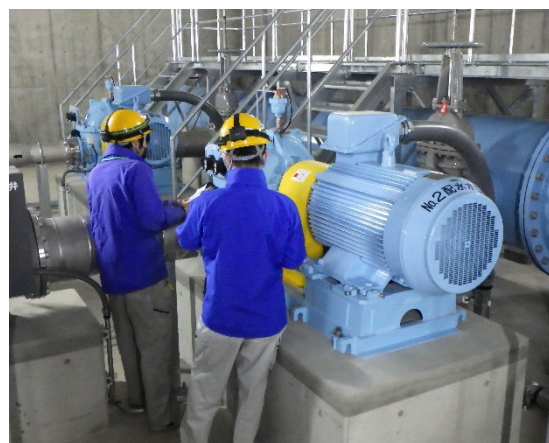
配水ポンプ設備点検の様子
