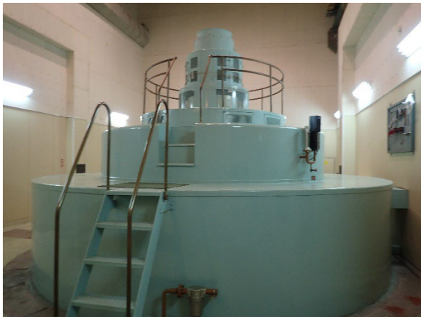
胆沢第二発電所 発電機
