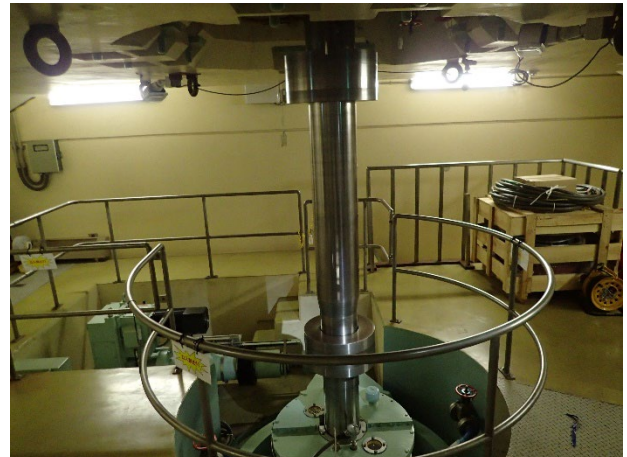
入畑発電所 水車設備
