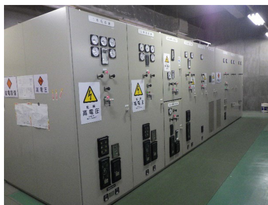
第三浄水場高圧受電設備
