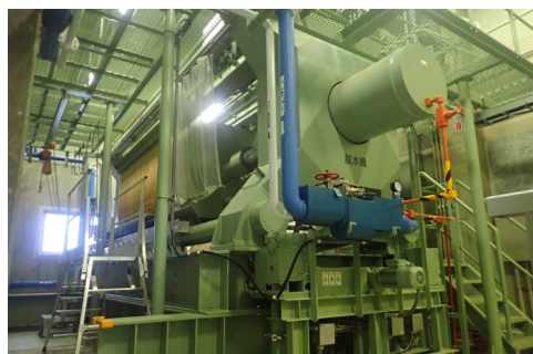
第三浄水場 加圧脱水機(更新後)
