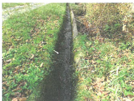
側溝剥き出し傾斜 (北緯 39° 10' 31.60" 東経 141° 47' 31.60" 付近)
