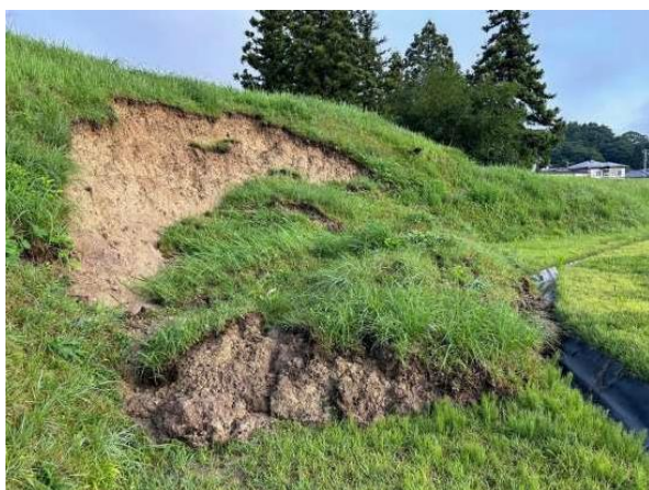
無量光院土塁崩落
