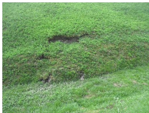
柳之御所遺跡崩落
