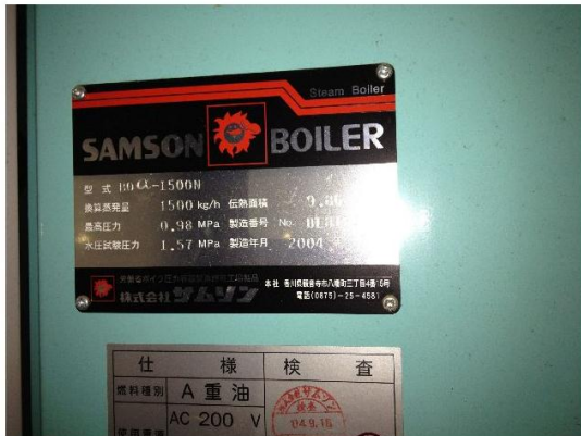
野田小学校 現ボイラー
