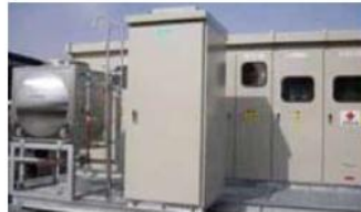
パワーコンディショナは常時は通常の系統連系運転を行うが、非常時には電力系統から切り離され自立運転する。
