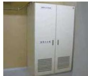
鉛蓄電池は、288V・100Ah で電力容量に換算すると約 28.8kWh の容量がある。
