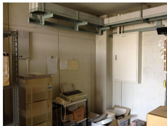
二戸市総合福祉センター_電話交換機室
