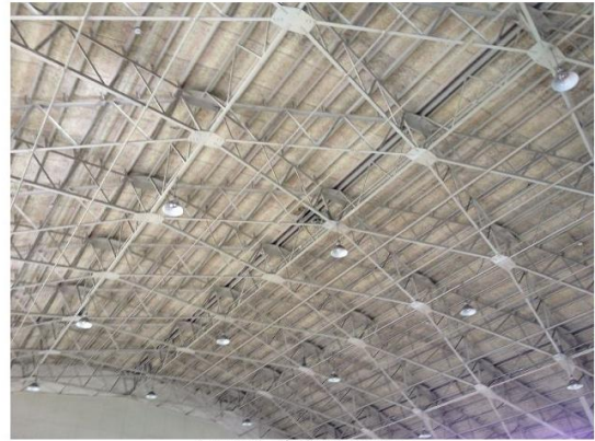
厨川小_体育館_照明1
