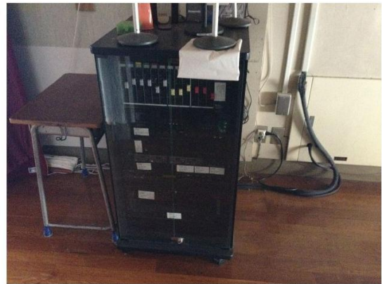
盛岡市_厨川小_体育館_放送設備
