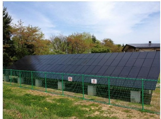
松園小_太陽光発電外観
