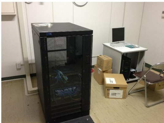
二戸市総合福祉センター_サーバー
