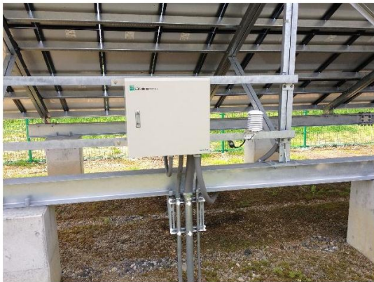
松園小_太陽光発電パワコン
