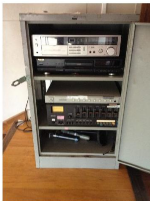
松園小_体育館_放送設備
