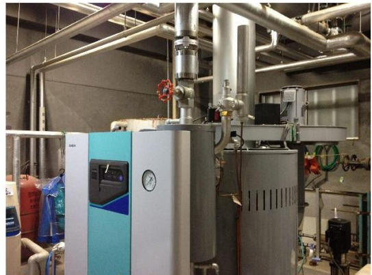
野田小学校 現ボイラー外観
