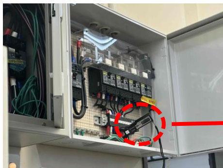
<分電盤内に設置>
