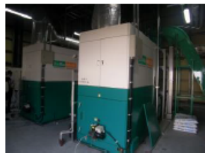
チップボイラー
