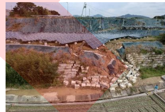
法面保護工が崩れて流出した事例
