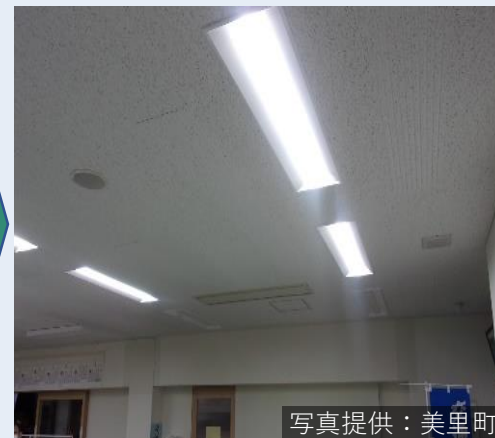
<蓄電池使用時>
