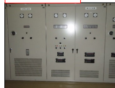
電気設備(受電設備)
