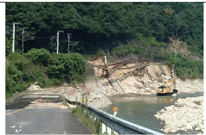
鉄道の被害 （広島県東広島市 JR山陽線）
