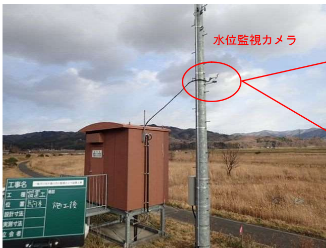
水位監視カメラの設置状況
