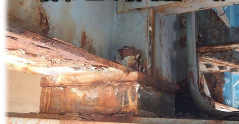
【橋げたの腐食】
