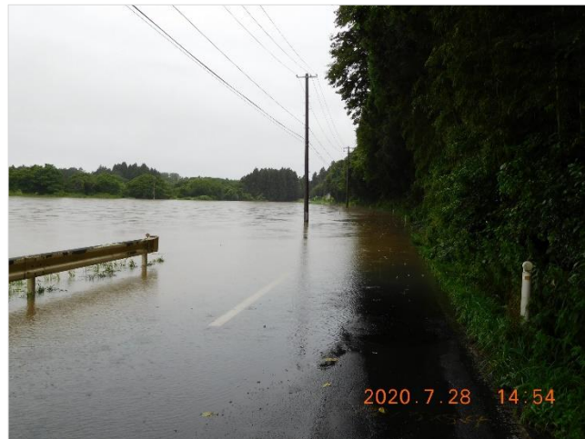
令和2年7月28日の豪雨による路面冠水
