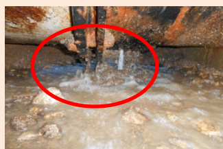
【経年劣化による腐食の発生(建設後約25年)】
