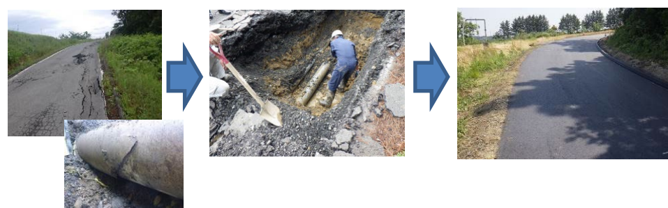
【パイプラインの突発事故への対応状況】
