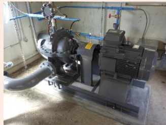
主ポンプ(更新後)
