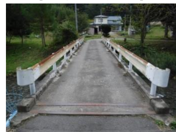
【老朽化が進む農道橋】
