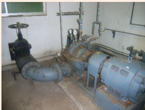
主ポンプ(更新前)
