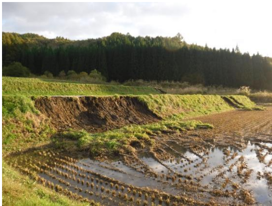
【田の法面崩落】
