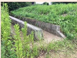
洪水吐の流下能力不足
