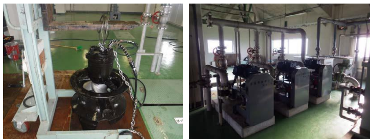
【農業集落排水施設のばっ気攪拌装置、汚泥引抜ポンプ】
