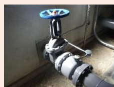
仕切弁(更新後)
