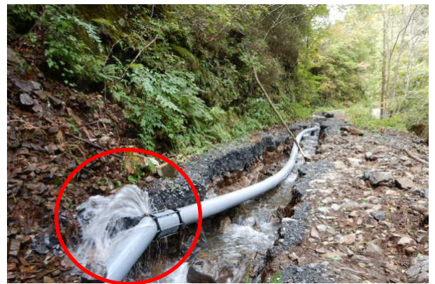
【パイプラインの露出・破損】
