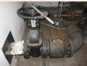
仕切弁(更新前)
