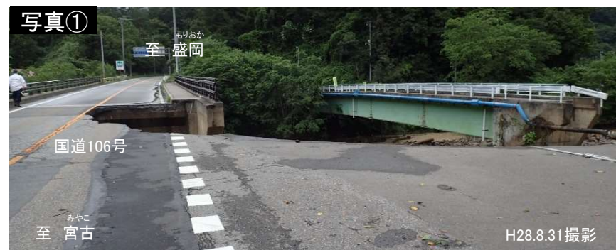
《平成28年8月台風10号被災状況》
