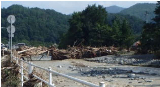
橋梁の流木被害状況(田中橋)
