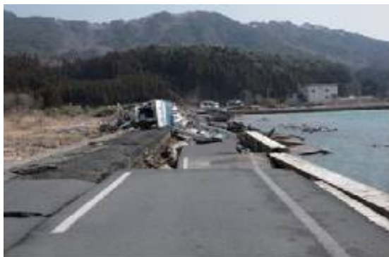
【整備前の県道の被災状況】
