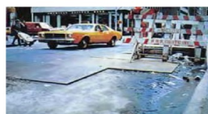
【損傷が進んだ舗装】
