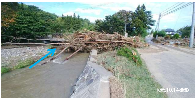
小屋畑川被災状況(R1台風)
