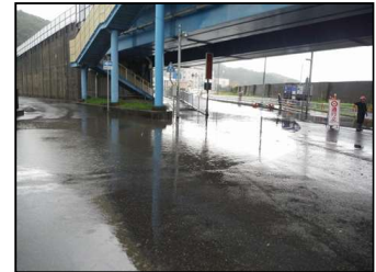
冠水状況(R3.9.15)
