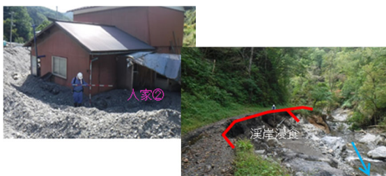
被害状況：本銅口の沢（岩泉町）
