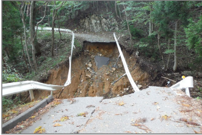
主要地方道重茂半島線の崩落（宮古市）
