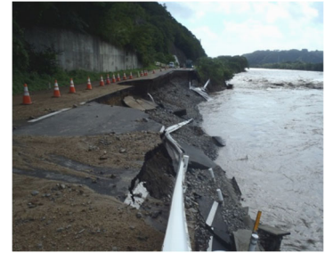
国道106号の被害状況（宮古市）
