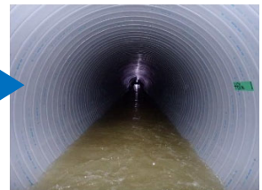
④ 対策完了
