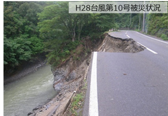
H28台風第10号被災状況 一般国道281号 案内～戸呂町口地区（久慈市）
