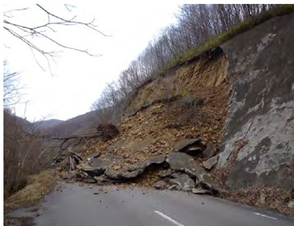
モルタル吹付老朽化による法面崩落状況
