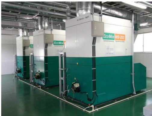
木質バイオマスボイラー
