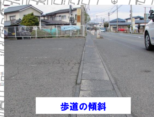
側溝蓋の浮き
