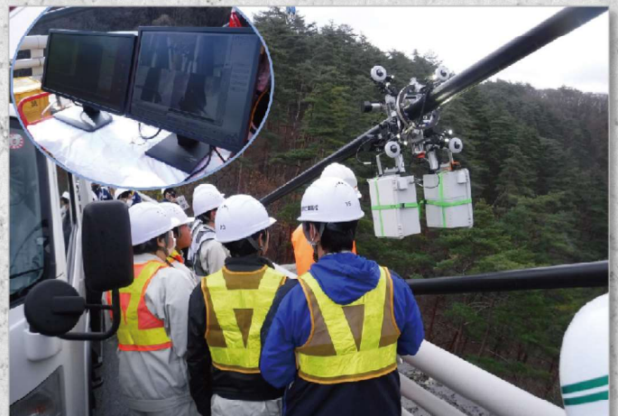
高校生との協働による道路インフラメンテナンスの取組
