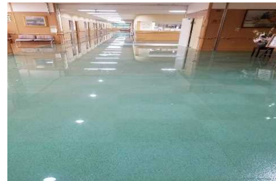
介護老人保健施設 舟形徳洲苑 浸水状況(平成30年8月6日)
