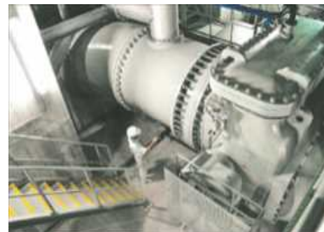
雨水ポンプの整備
