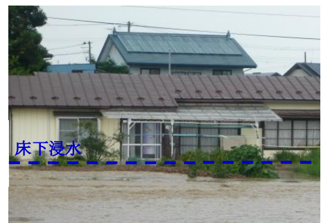
浸水被害状況 (平成25年8月)
